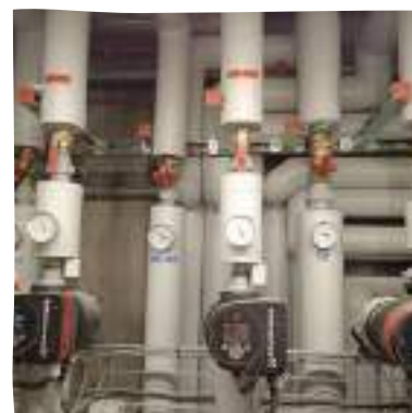
Quelques photos prises lors de la visite de la chaufferie par des éco-délégués du collège
